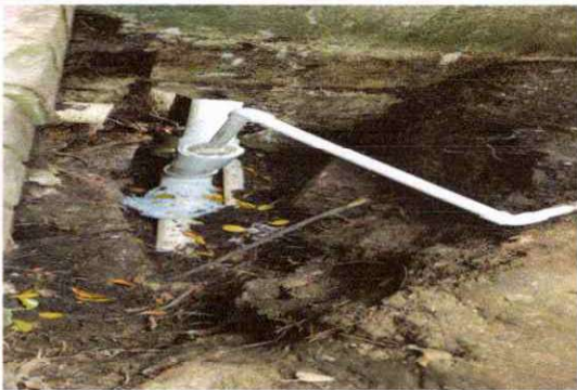
Foto 3: SUSTITUCIÓN DE TUBERÍA POR FUGA DE AGUA EN GRADAS EN JARDINERA COMPARTIDO CON LA JORNADA MATUTINA.
